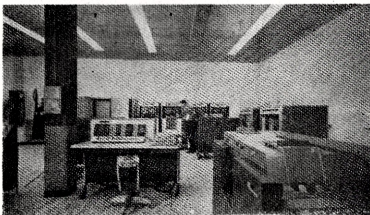
Pomieszczenie aparatury kontrolnej
